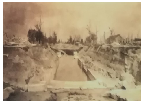
L'écluse détruite par la guerre 1914-1918, au début de la reconstruction. A droite, les ruines de la verrerie.
